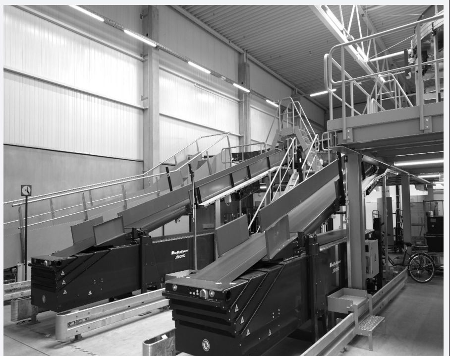
Abbildung 2: Sortieranlage einer mechanischen Zustellbasis (MechZB)
